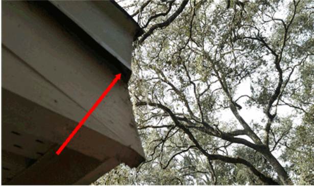
Improper drip edge
